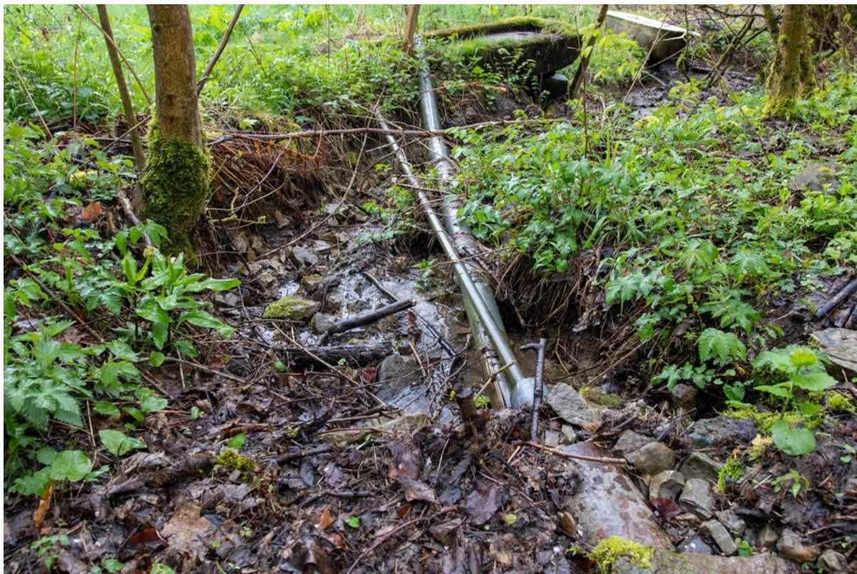
Abb.: Verrohrung und Viehtränke
